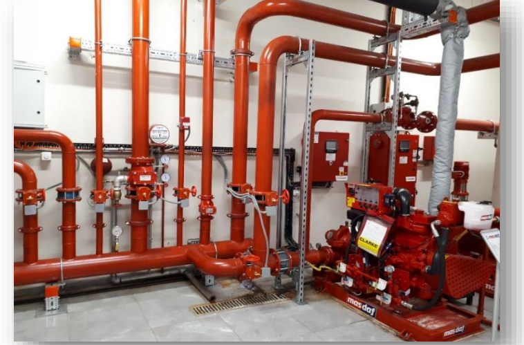
Yangın Pompa Dairesi
