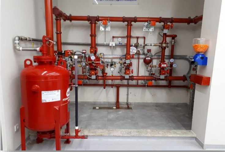
Alarm Vanası İstasyonu
