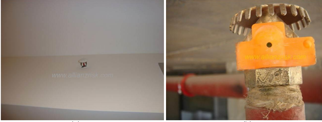
(a) (b) Resim 5: Yanlış sprinkler başlığı kullanımı (a) ve koruyucu kapakları halen çıkarılmamış sprinkler başlığı (b)
