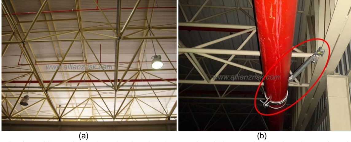
Resim 9: Yağmurlama sistemi tesisatı borulamasında sabitleme ve bağlantılarında esnek geçiş yapılması; Yanlış uygulama (a); Doğru uygulama (b)
