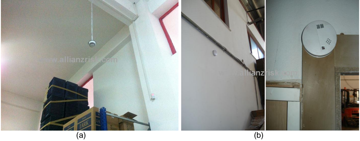
Resim 4: Yerleşim yerleri hatalı olan duman dedektörleri: Standartlarda izin verilen sınırlardan çok daha aşağıya yerleştirilmiş (a); Tavan yerine duvara monte edilmiş (b)
