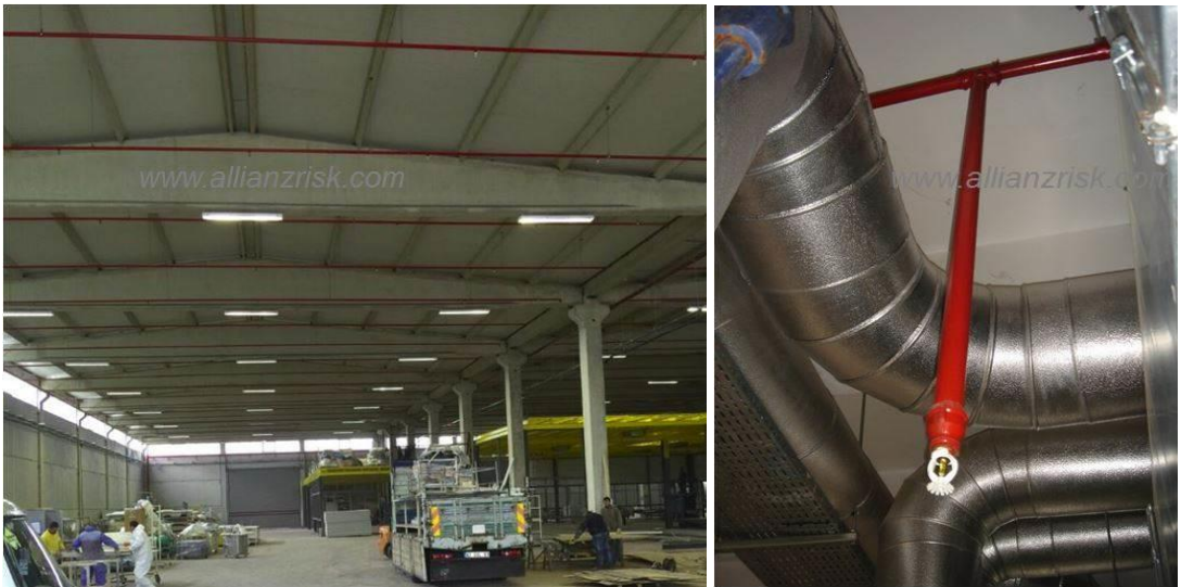
(a) (b) Resim 7: Sprinkler borulamasında çatı eğiminin dikkate alınmaması (a); tavadan oldukça aşağıya monte edilmiş sprinkler başlığı (b)
