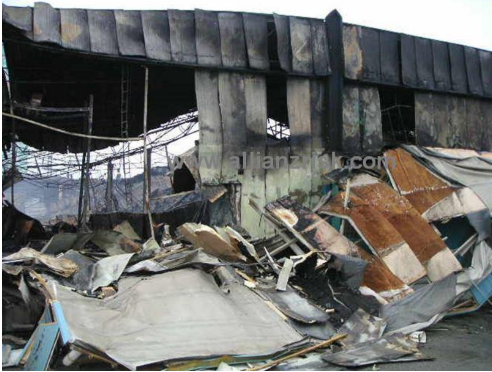
Resim 2: Yanıcı özellikteki malzemeler ile izole edilmiş kompozit panellerin tipik yangın davranışı
